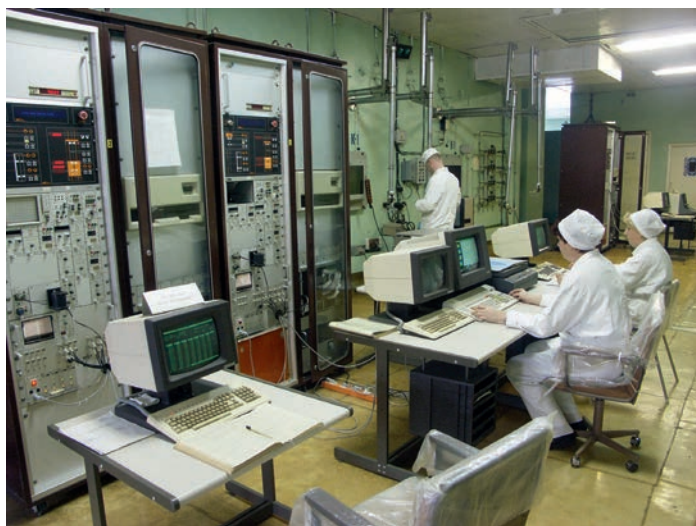
Операторская защитной камеры К-1
