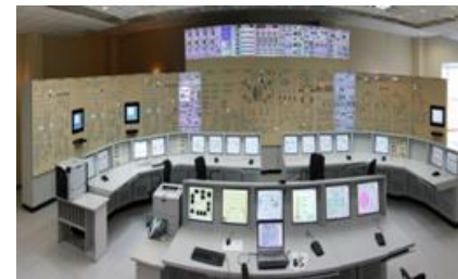
Блок 4 Калининская АЭС ПМТ для блока ВВЭР-1000
